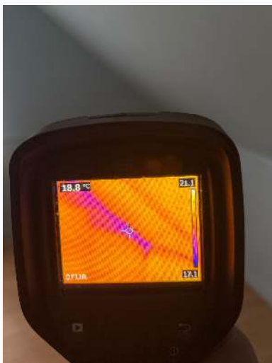
Isolant manquant haut des murs
