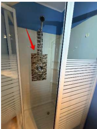
ouverture non étanche
